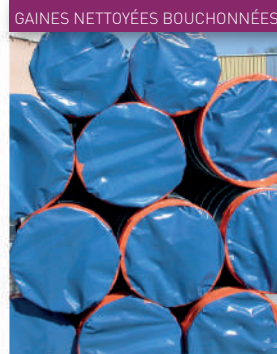
GAINES NETTOYÉES BOUCHONNÉES
